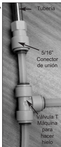
Foto 7 Ejemplo Instalación de la máquina para hacer hielo
