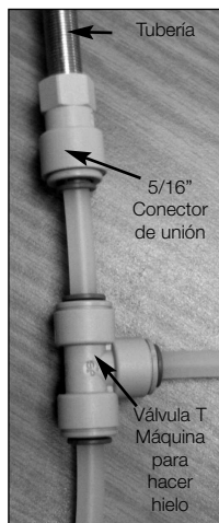
Foto 6 Ejemplo Instalación de la máquina para hacer hielo
